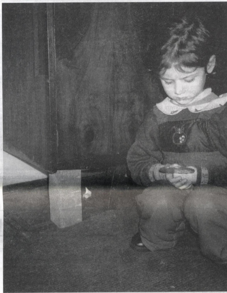
Na parterze wilgoć jest tak duża, że meble trzeba podpierać cegłami. Szafy stoją puste, gdyż nie nadają się do przechowywania ubrań.
